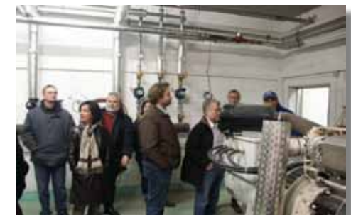
FWG besichtigt die Biogasanlage auf dem Andreashof bei Rechtenbach
